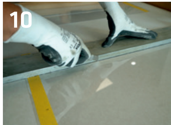
Der Zuschnitt der Schalungsfolien erfolgt mit einem Cuttermesser. Die Folien sind mehrfach nutzbar und können mit Wasser gereinigt werden.
